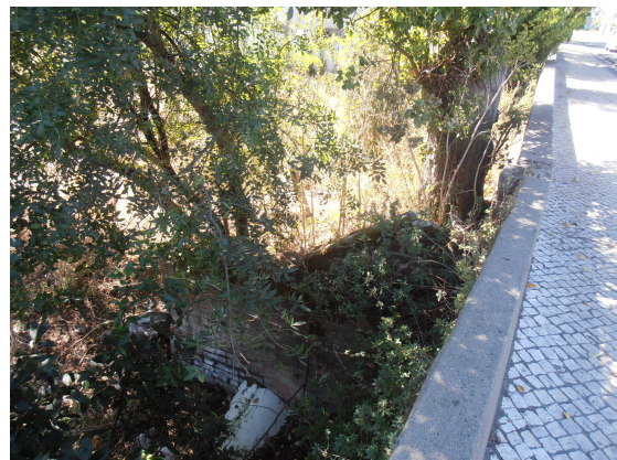
Ilustração 6: Deslocamento do muro
