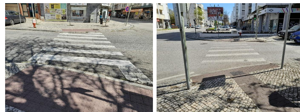
Figura 40. Exemplo de execução indevida de passeadeira tátil (esquerda) e rebaixamento mal executado (direita) associados a atravessamentos pedonais na área de estudo Fonte: mpt®, 2022
