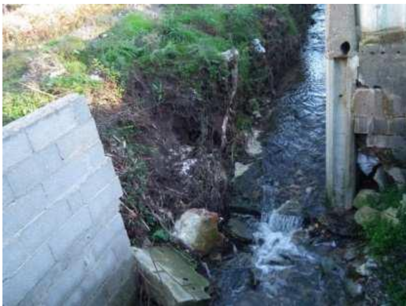
Figura 5 - Ponto de controlo n.º 3 - Linha de água estrangulada por muro provocando a erosão do talude – Ribeira do Tecelão – Rua 1.º de Dezembro, Amieirinha
