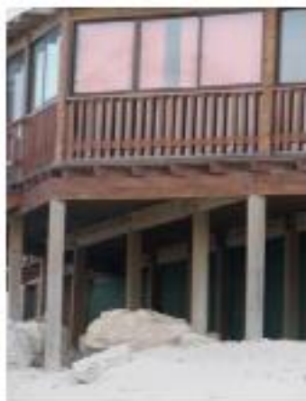
Figura 10 - Descalçamento de estruturas mestras do apoio de praia por marés vivas, na Praia da Vieira, em dezembro de 2008
