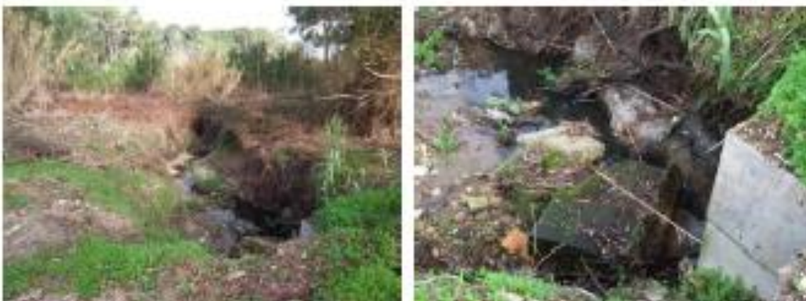
Figura 9 - Ponto de controlo n.º 55 – zonas com acentuada erosão do talude e entulho na vala – vala do Barqueiro, Rua da Areia Vermelha
