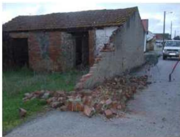
Figura 12 - Queda de muro de habitação degradada para a via pública, por ação de vento e chuvas fortes (janeiro de 2009)
