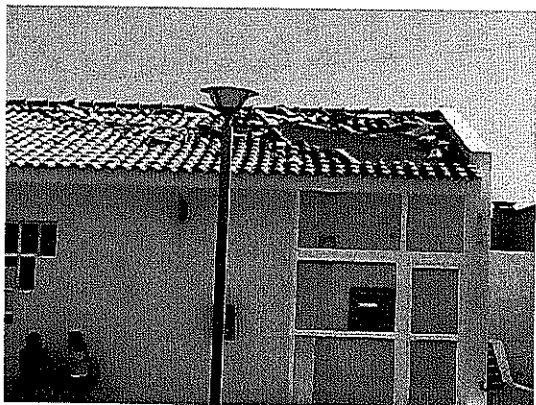
figura 3 - danos na cobertura
